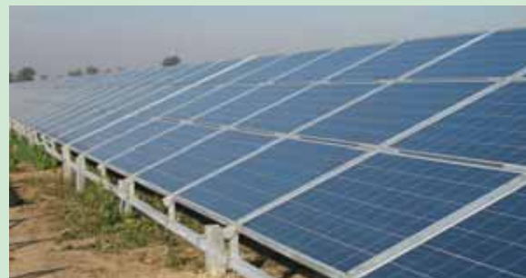
Impianto fotovoltaico a terra in lombardia.
